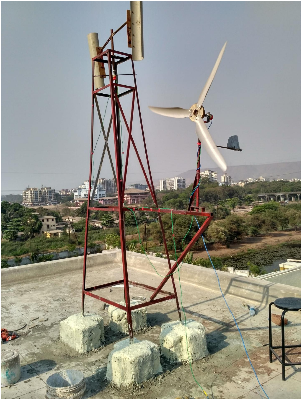
Fig.5.19 Actual setup of Wind Turbines
