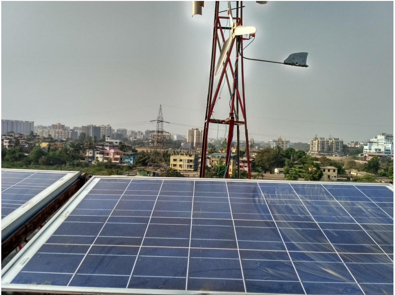
Fig.5.20 Actual setup of solar system
