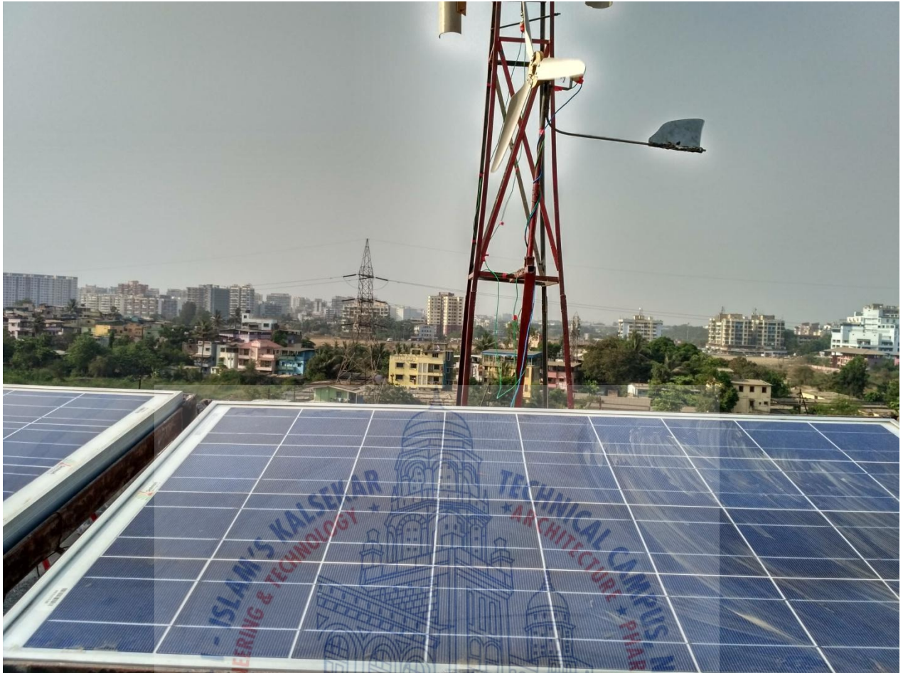
Fig.5.20 Actual setup of solar system
