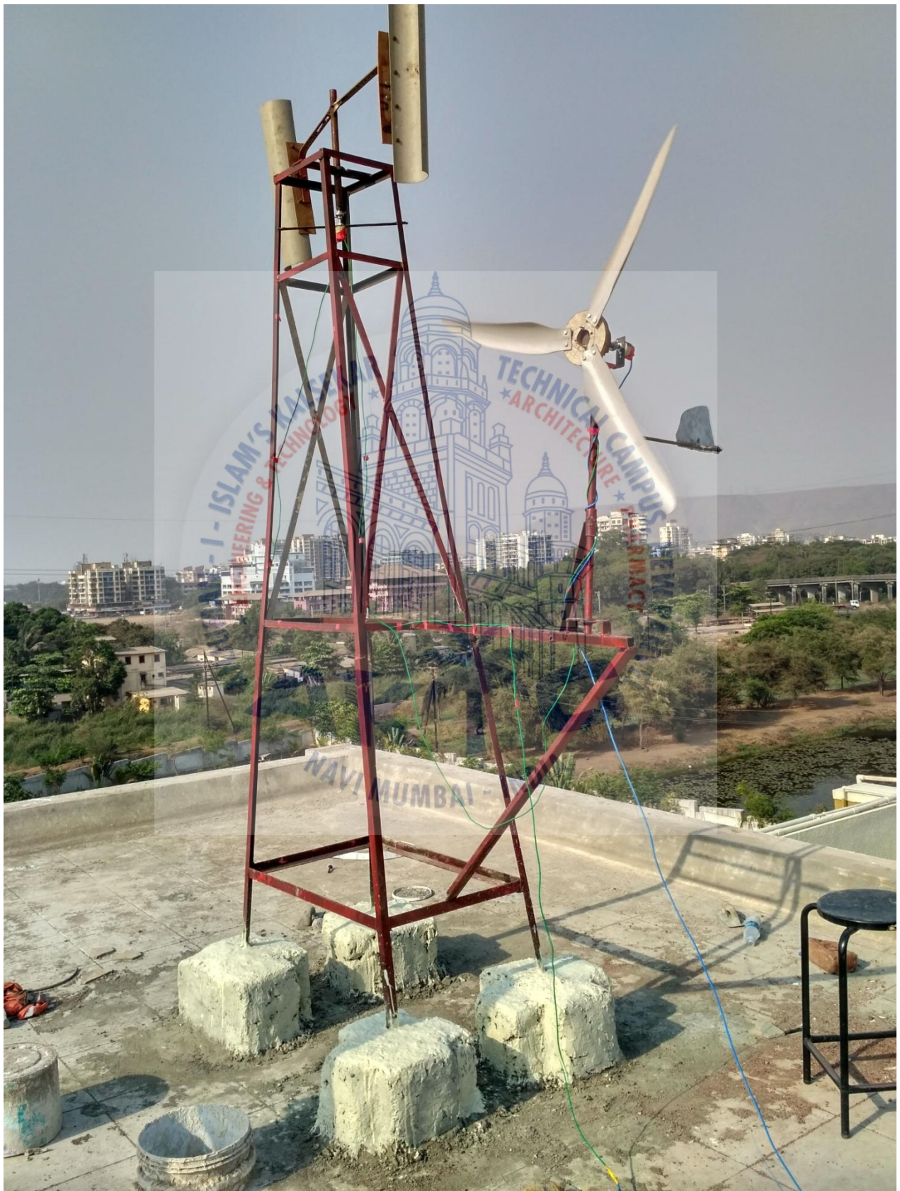
Fig.5.19 Actual setup of Wind Turbines
