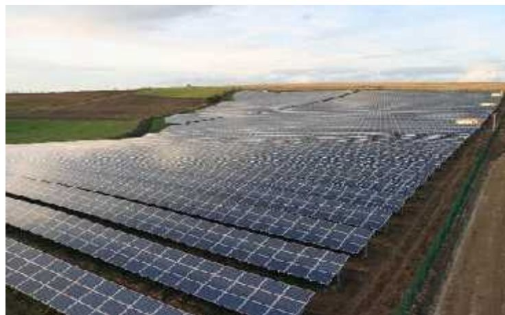
Fig 11.2 SOLAR ARRAY GRID
